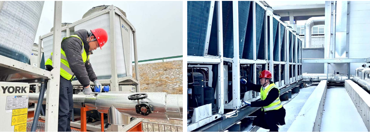
▲ 济郑高铁能源站、青连铁路青岛西能源站持续高效运行
