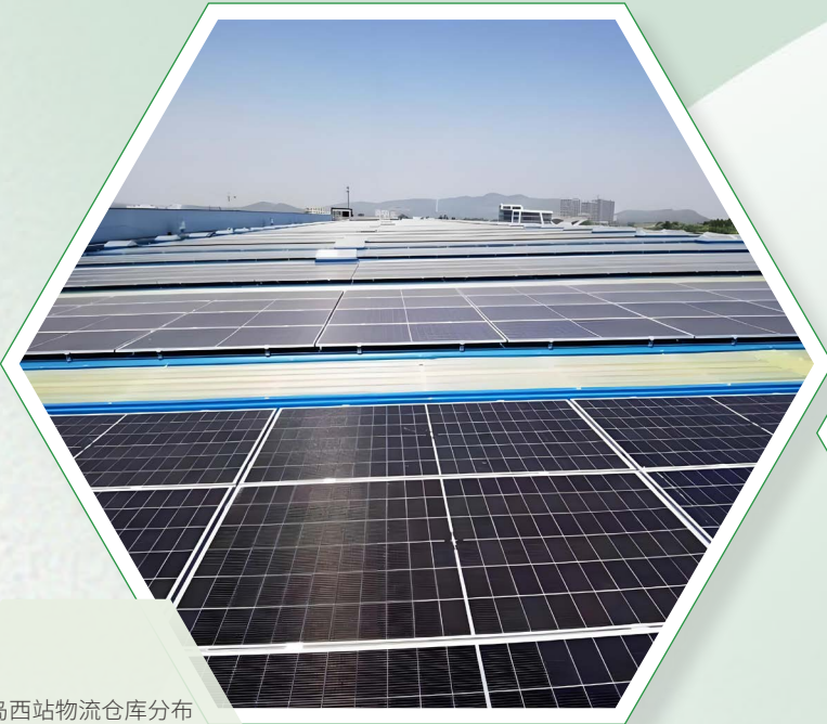
青岛西站物流仓库分布式光伏发电项目，预计每年减排二氧化碳 2000 吨
